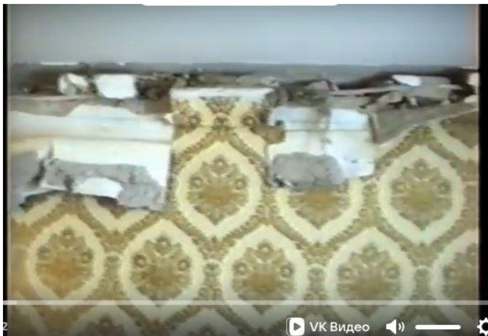
Фото.12. На фото зафиксировано механическое повреждение участка соединения углового стыка потолка и стены.
