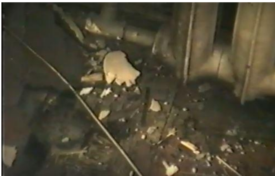
Фото.6. В комнате, возле угла стены в полу выбит бетон до арматуры с размером повреждения бетонного пола приблизительно 10 на 15 см. Там же взломан деревянный пол и его обломки оказавшись на дереве обуглены.
