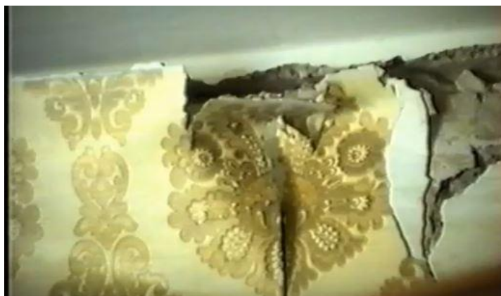
Фото.13.Укрупненный фрагмент механического воздействия энергии, сконцентрированной из внешнего пространства по угловому стыку потолка и стены сконцентрированной из внешнего пространства в определенную область волнового максимума энергии.
